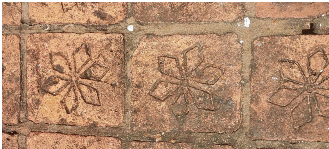
Legenda: Estado de conservação do piso decorado. Autoria: Francielle Ferreira Data: 29/02/2024
